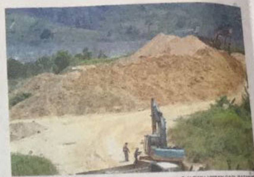
TAMBAK pasir ilegal beroperasi di dekat Dam Tembesi, Sagulung, belum lama ini. Aktivitas itu dikhawatirkan bisa membuat dinding dam tersebut jebol.
